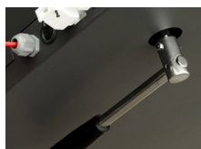
Nettoyage des turbulateurs
